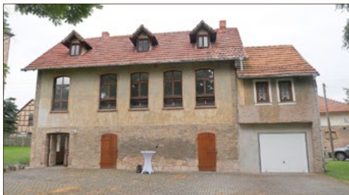
Das sanierungsbedürftige Bürgerhaus in Ellicheben Bildautor: Marie-Luise Will Bildrechte: RAG Gotha-Ilm-Kreis-Erfurt e.V.
